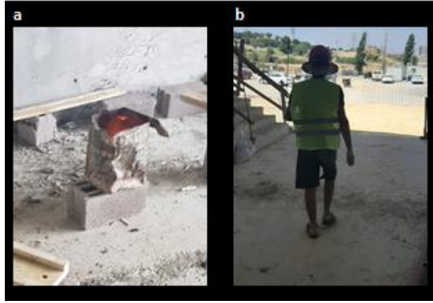
Şekil 8. Çalışma ortamında termal konfor şartlarından kaynaklanan bazı uygunsuzluklar. a) Şantiyede ısınmak için çalışanların yaktığı ateş, b) Sahada sıcak havadan dolayı KKD kullanmayarak tehlikeli davranışta bulunan bir çalışan.
