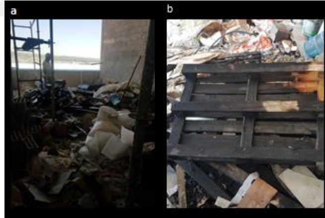
Şekil 14. Şantiye sahasındaki düzensizlik ve atıklar. a) Biriktirilen atıklar, b) Biriktirilen atıkların, sigara izmaritinden çıkan bir yangınla yanması
