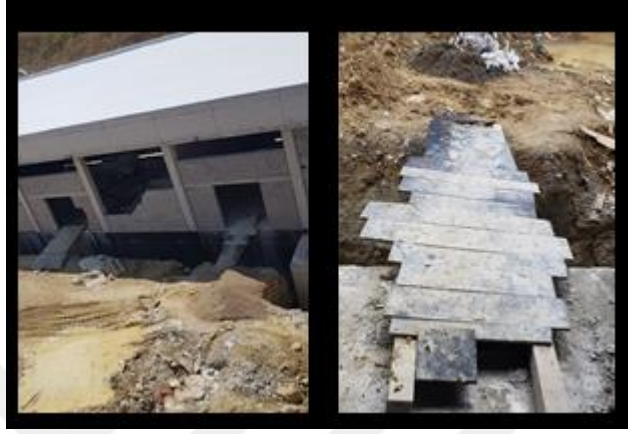
Şekil 13. Kazı çalışmalarında kullanılan güvenliksiz geçiş platformları.
