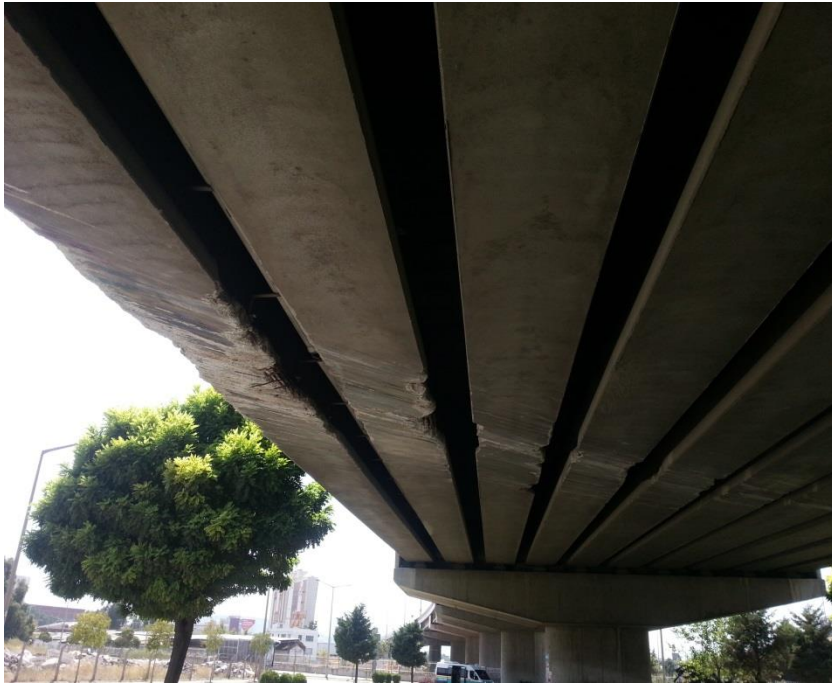
Şekil 5: Köprünün hasarlı bölgesinin alttan görünüşü
