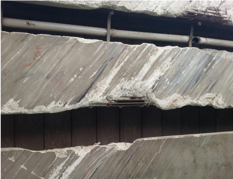
Şekil 7: Köprünün hasarlı bölgesinin beton kırılması ve donatının açığa çıkması
