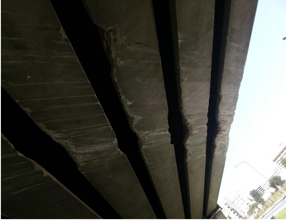
Şekil 6: Köprünün hasarlı bölgesinin alttan görünüşü
