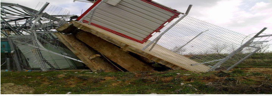
Resim 1. İstasyon üzerine yıkılmış kule (Vodafone BÇO, 2008).
